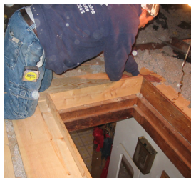
Un contratista de CEDA instala una puerta aislada en el ático antes de poner insulacion
