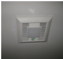
Ventilacion de un Abanico ASHRAE mantiene el flujo de mejor calidad de aire en su hogar
