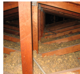
El ático necesita más insulacion. El programa de energia les puede ayudar con eso.
